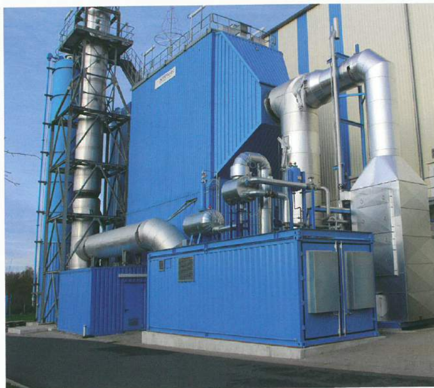
Bild 2: Abwärmekraftwerk an einer Glasschmelze
