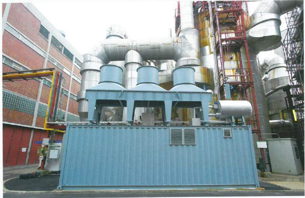
Bild 3: Kühlluft aus einer Säurespaltanlage dient als Abwärmequelle
